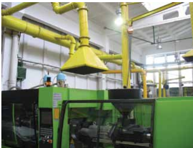
Rys. 3 Odciągi miejscowe instalacji wywiewnej nad wtryskarkami [10]
