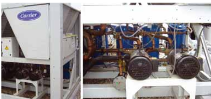
Rys.3. Pompy odśrodkowe czynnika chłodniczego ze sprzęgłem magnetycznym wykorzystywane w systemie DX free-cooling firmy Carrier
