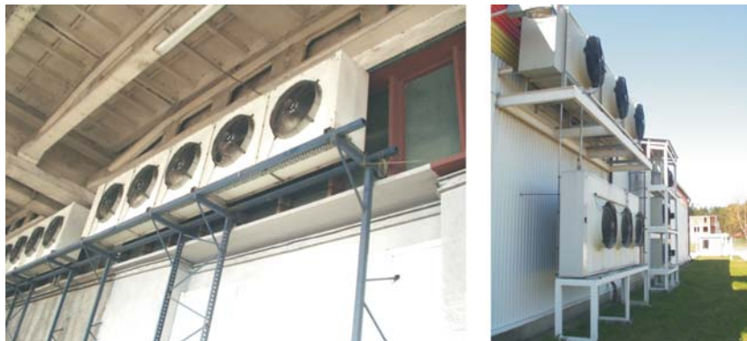
Rys. 4 Przykładowe sekcje skraplaczy zainstalowanych w dojrzewalni bananów [5,6]
